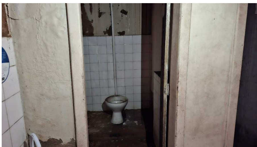
Imagem 6 – “Igrejinha” descaracterizada reformada como banheiro (autoral), 2026
