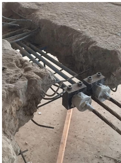
Figura 9 – Escorregamento nas ancoragens
