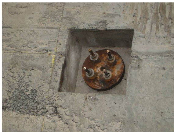
Figura 11 – Sistema de ancoragem oxidado
