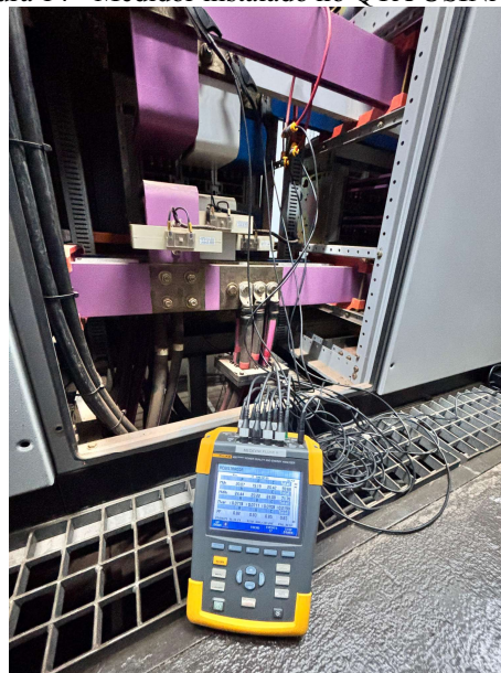
Figura 14 - Medidor instalado no QTA USINA 500
