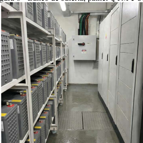
Figura 8 - Banco de bateria, painel QTM e UPS
