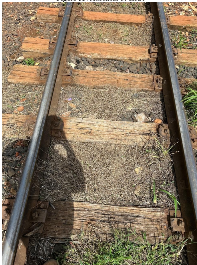
Figura 53: Ausência de lastro
