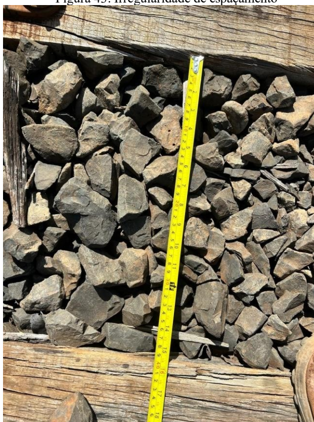
Figura 43: Irregularidade de espaçamento
