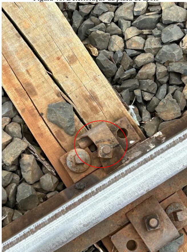
Figura 46: Deterioração da placa de apoio
