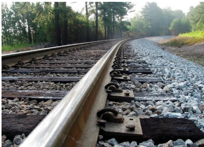
Figura 09: Placas de apoio
