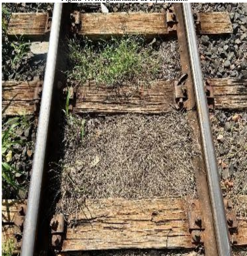
Figura 41: Irregularidade de espaçamento
