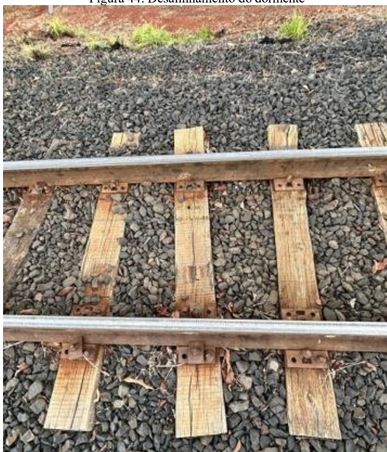
Figura 44: Desalinhamento do dormente
