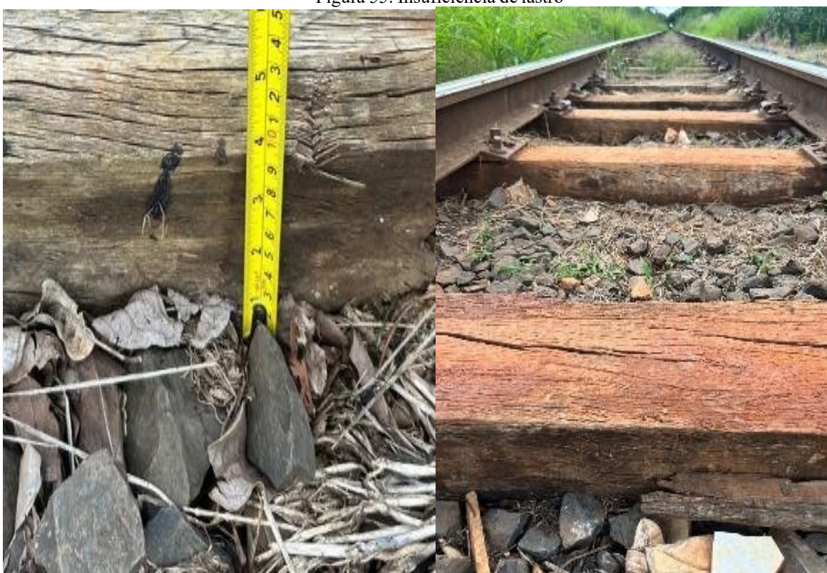
Figura 55: Insuficiência de lastro
