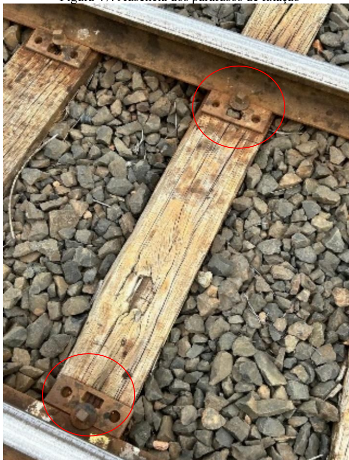
Figura 47: Ausência dos parafusos de fixação
