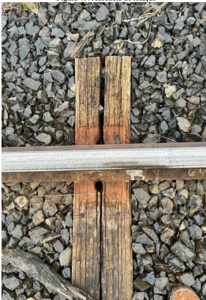
Figura 49: Ausência de fixação
