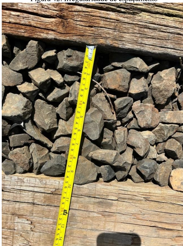
Figura 42: Irregularidade de espaçamento
