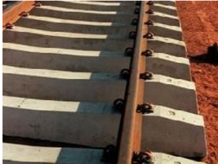
Figura 26: Dormentes de concreto
