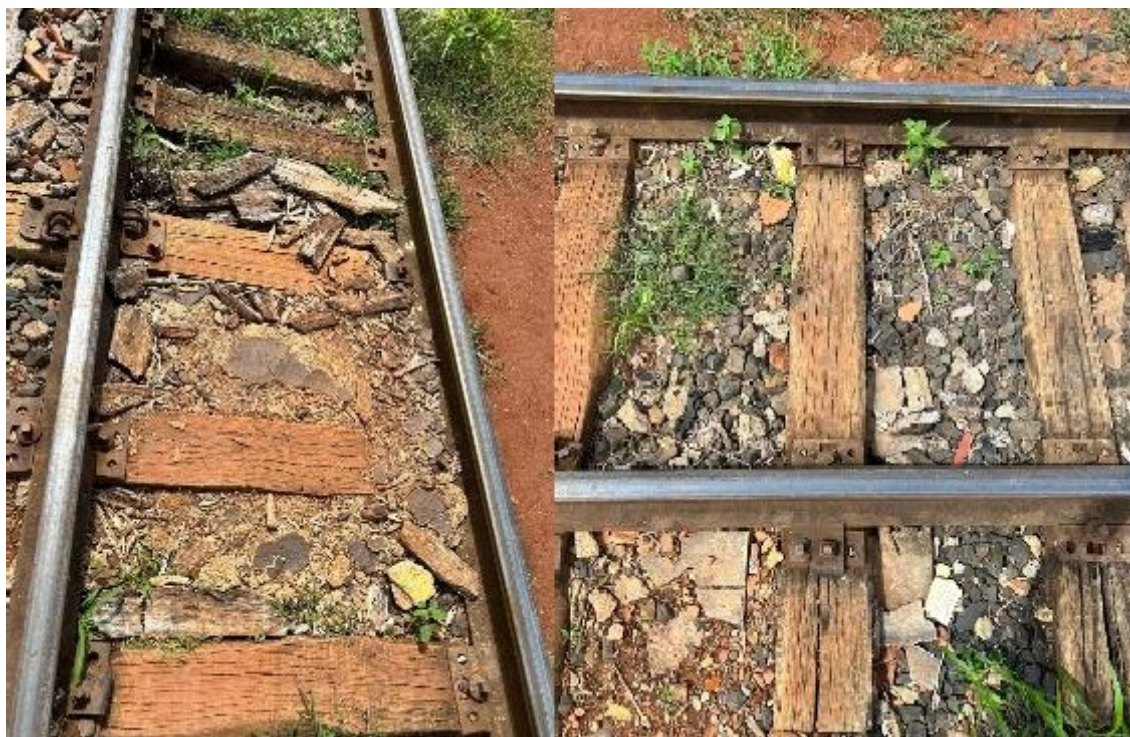
Figura 50: Colmatagem externa do lastro
