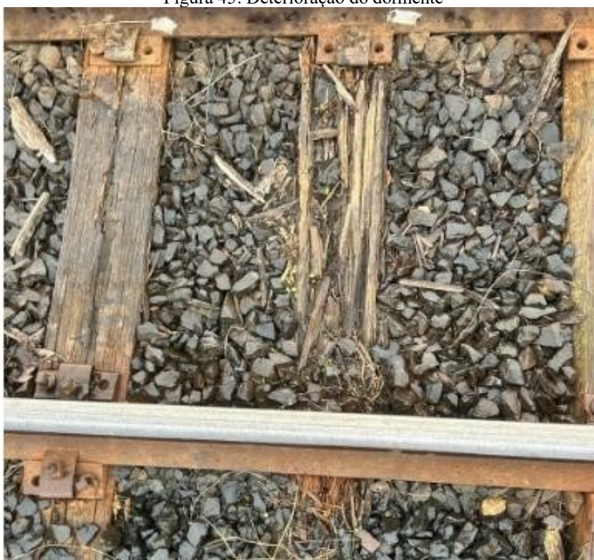
Figura 45: Deterioração do dormente
