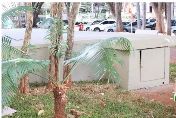
Caixa energia elétrica
