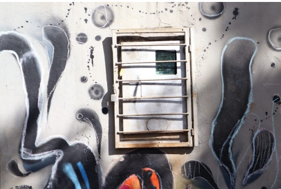
Padrão energia elétrica
