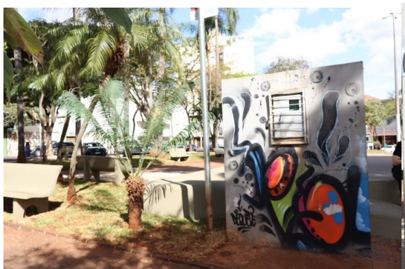
Padrão energia elétrica
