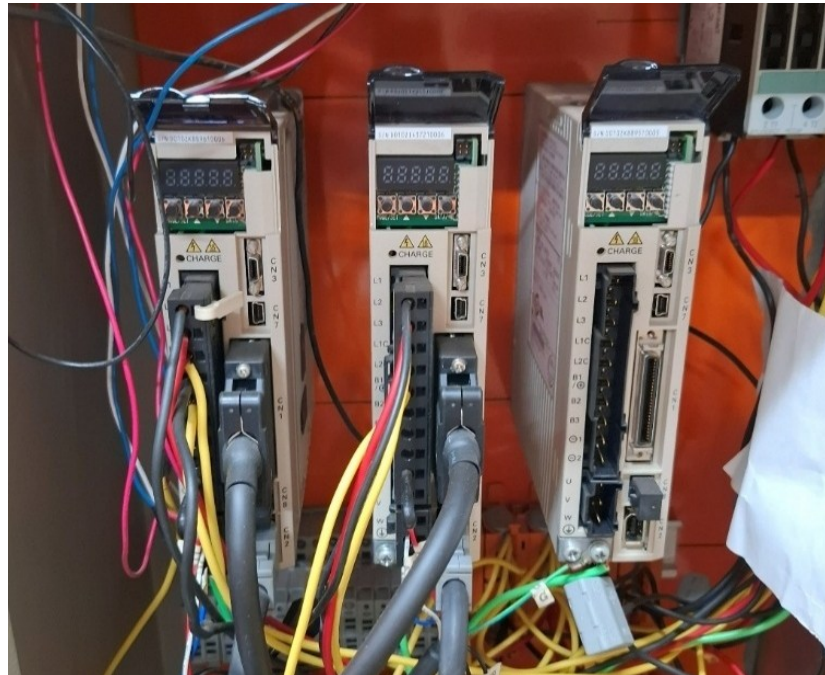
Figura 3.3: Servodrives Yaskawa montados no painel.
