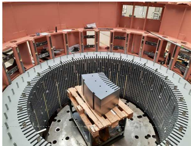
Figura 1 – Estator de gerador hidrelétrico.
