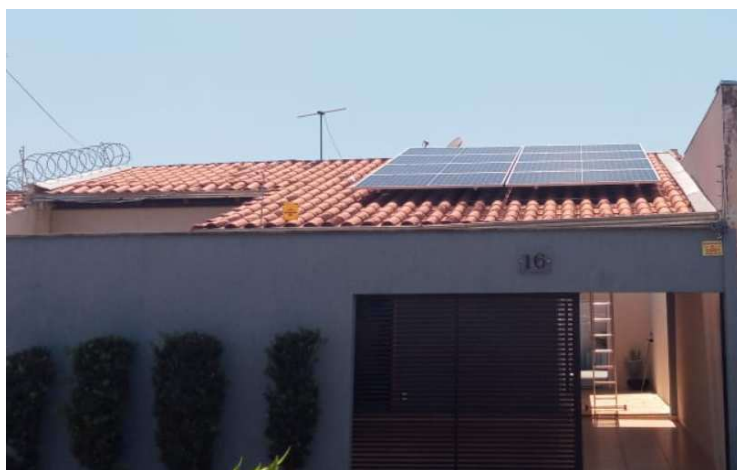
Figura 15 – Usina Analisada Inversor Tradicional
