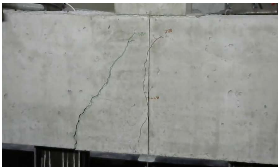
Figura 5.24 - Registro das primeiras fissuras no modelo B6E2 GFRP-10 ANC
