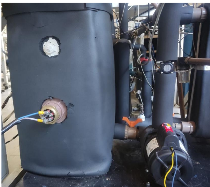
Figura 3.12 circuito secundário utilizado para a geração de carga térmica.
