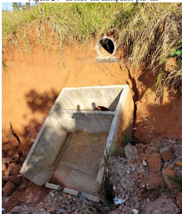
Figura 24 - Erosão em dissipador pluvial
