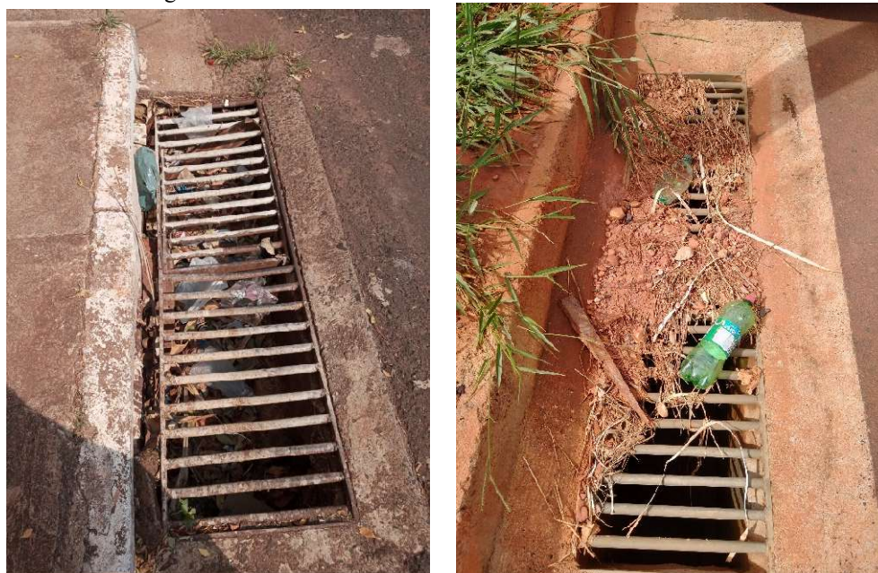
Figura 21 - Bocas de lobo com excesso de resíduos domésticos
