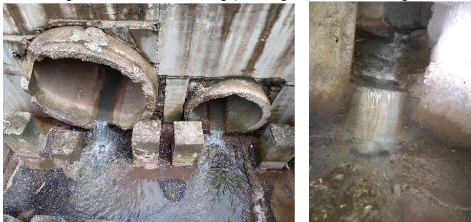
Figura 22 - Existência de interligação de esgoto em redes de drenagem
