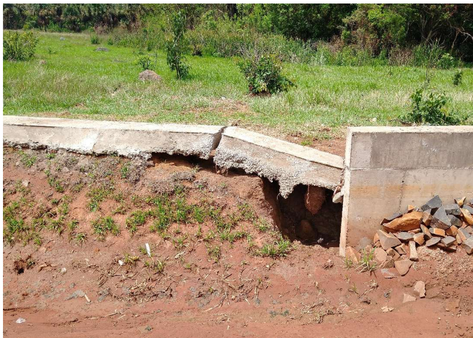
Figura 47 – Erosão sob a soleira
