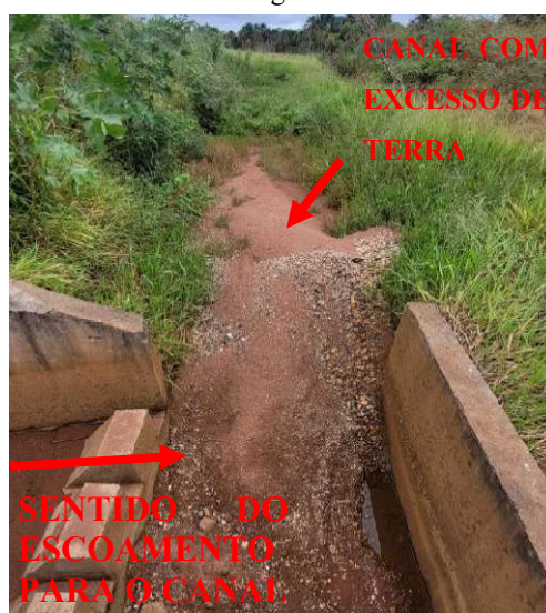
Figura 48 – Canal vertedor com grande volume de terra acumulada
