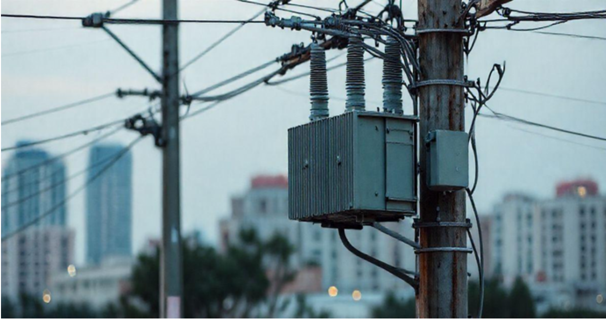
Figura 5 – Postes de Distribuição de Energia (Refortrafo Transformadores, 2025).
