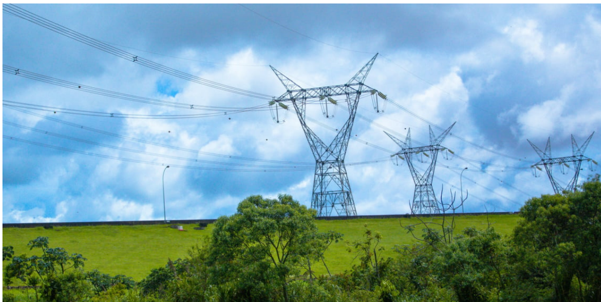
Figura 3 – Linha de Transmissão da usina de Itaipu, em Foz do Iguaçu (EIXOS, 2023).
