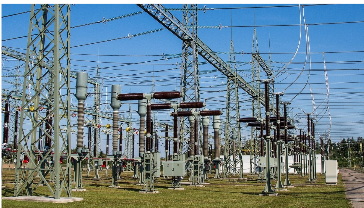
Figura 4 – Subestação de Energia (ENGENHARIA, 2020).
