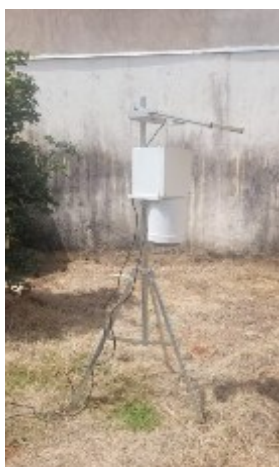
A – Estação instalada
