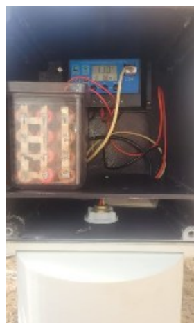
B – Conexão do sistema elétrico
