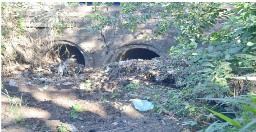
Figura 5: Resíduos acumulados nas manilhas do Córrego Buritizinho.
