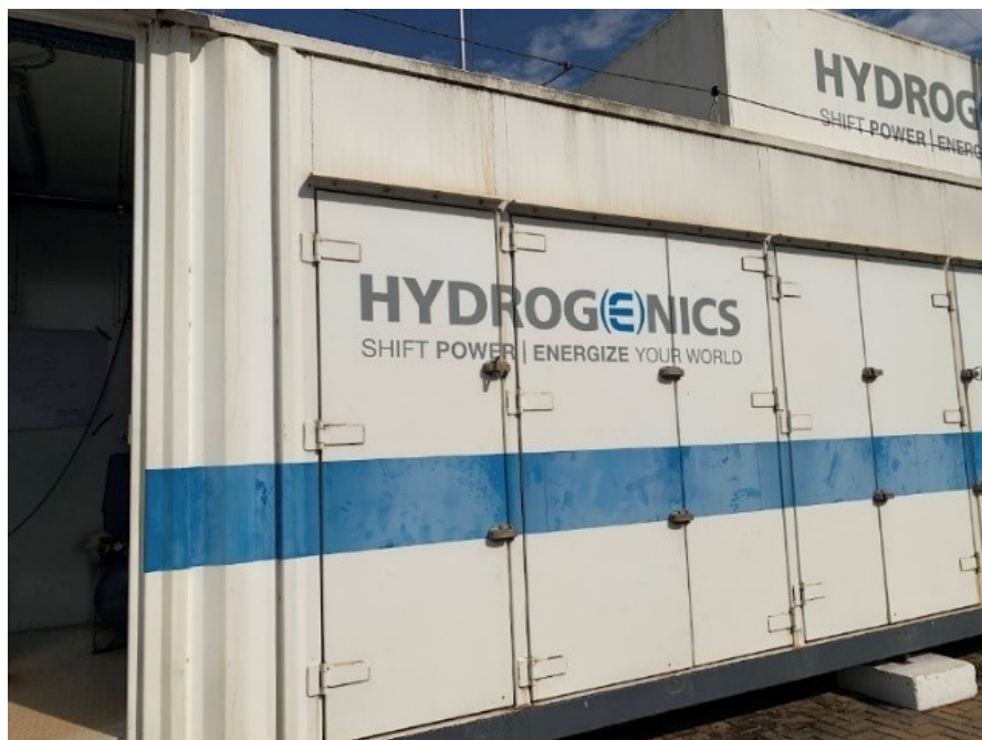
Figura 3.3: Eletrolisador alcalino Hydrogenics 60/27 utilizado no sistema em campo. Fonte: Autoria própria.
