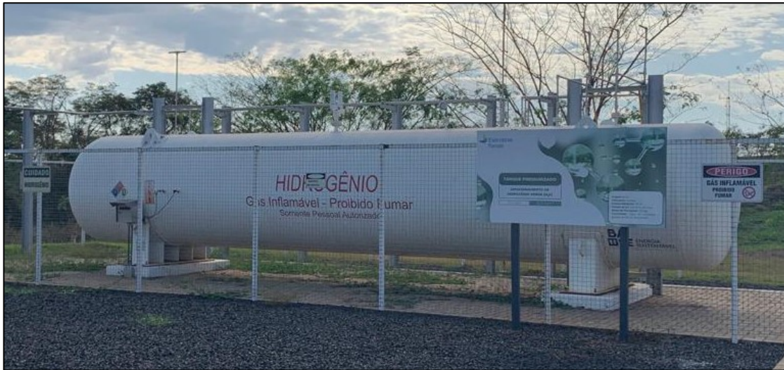
Figura 3.2: Tanque de armazenamento do gás hidrogênio. Fonte: Autoria própria.
