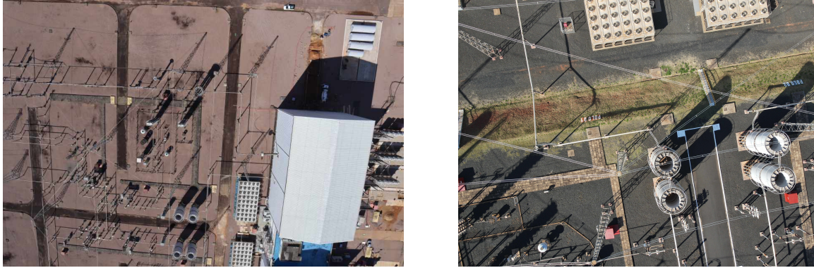
Figura 18 – Captura de foto em Porto Velho (à esquerda) e Araraquara (à direita), onde se notam quatro reatores de núcleo de ar na parte inferior.
