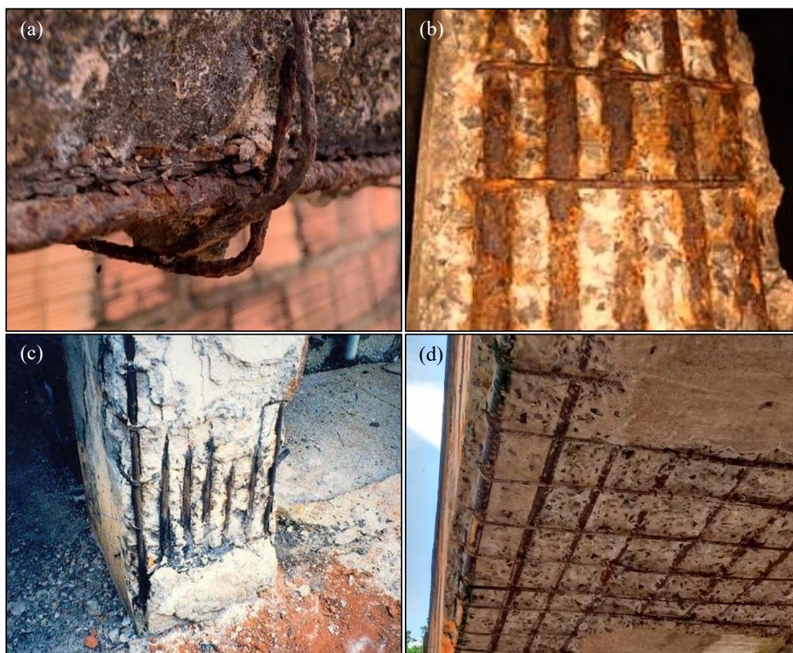
Figura 2: Exemplos de corrosão da armadura de aço.
