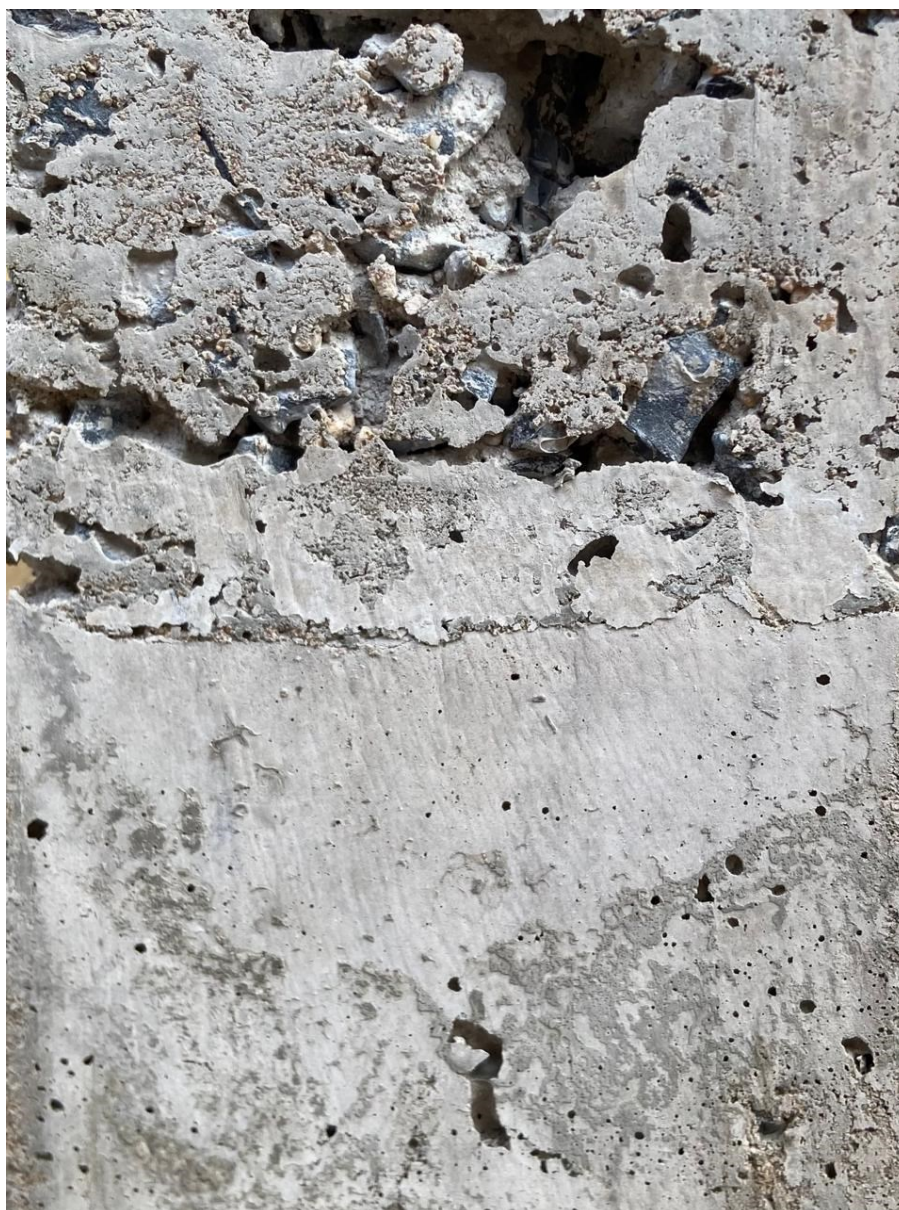
Figura 49 - Recorte do concreto dividido. 2024.
