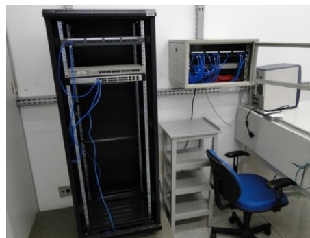
Figura 24 - Laboratório Unoeste – Armários de telecomunicações.
