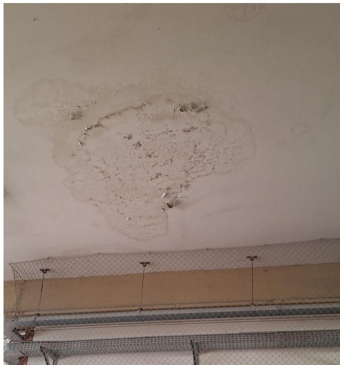
Figura 6: Infiltração na laje do 2º piso do bloco 1X
