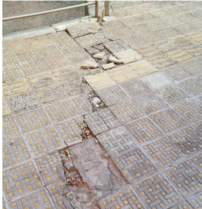
Figura 19: Patologias no piso do bloco 5R
