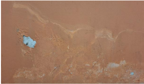
Figura 20: Infiltração no corredor no bloco 5R-A
