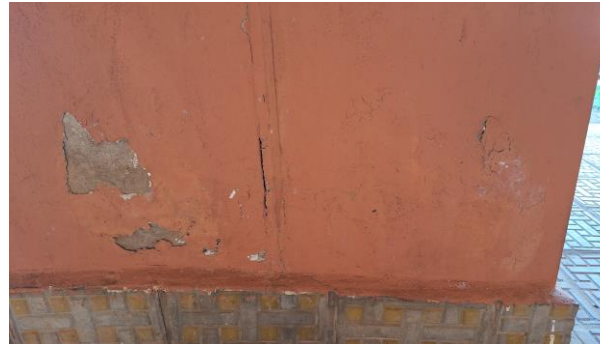
Figura 21: Infiltração no pilar do bloco 5R-A
