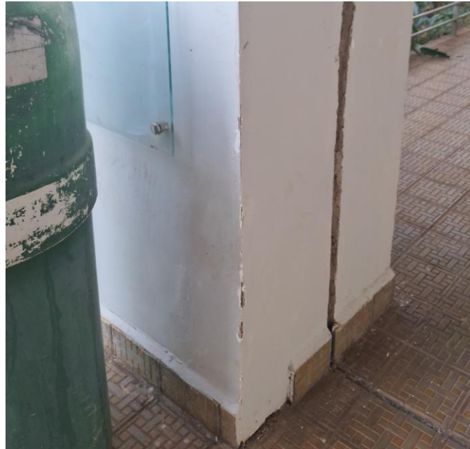
Figura 28: Rachadura no pilar no bloco 50-A
