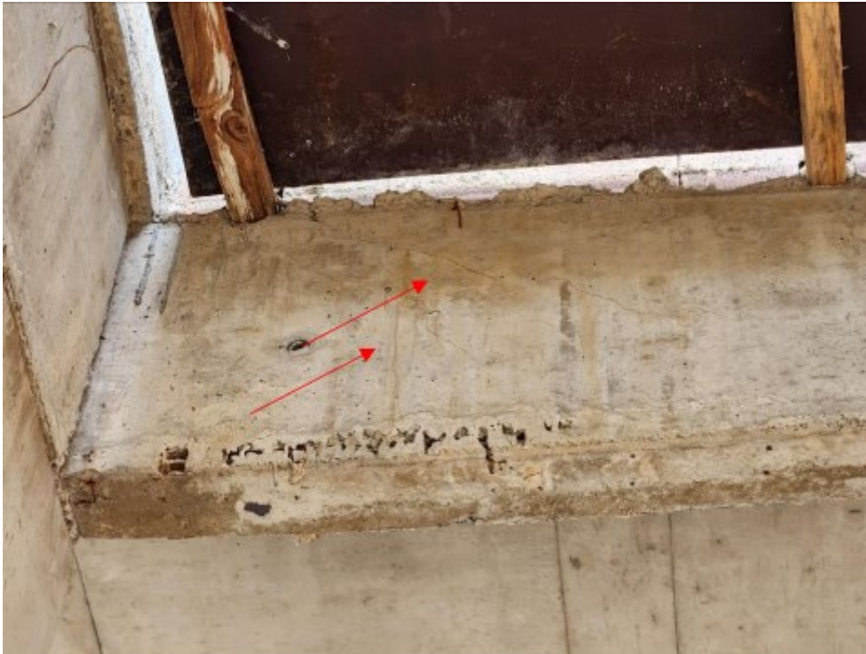
Figura 4 – Fissura em viga do 1º pavimento característica de cisalhamento por torção
