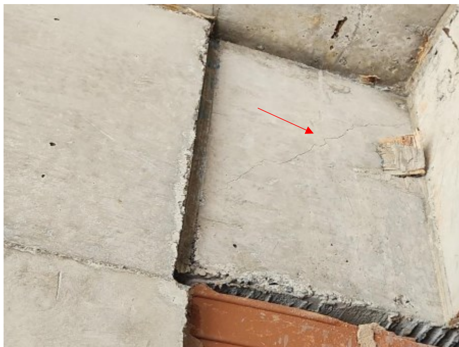
Figura 3 – Fissura em viga do 1º pavimento característica de cisalhamento por força cortante
