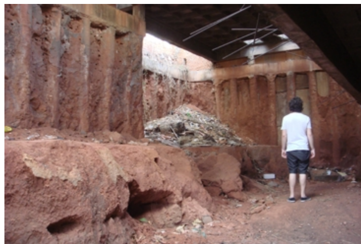
Figura 65. Ruína. Fonte: Guilherme Vendramini, 2013.
