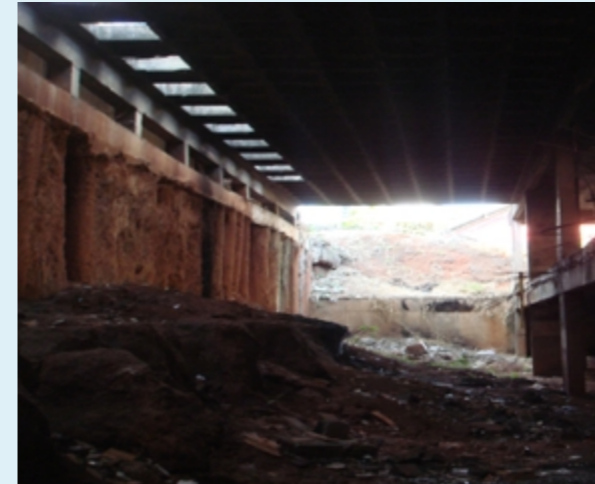
Figura 68. Ruína. Fonte: Guilherme Vendramini, 2013.
