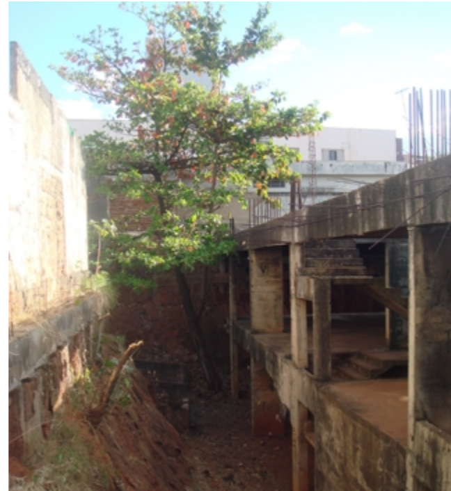
Figura 66. Ruína. Fonte: Guilherme Vendramini, 2013.
