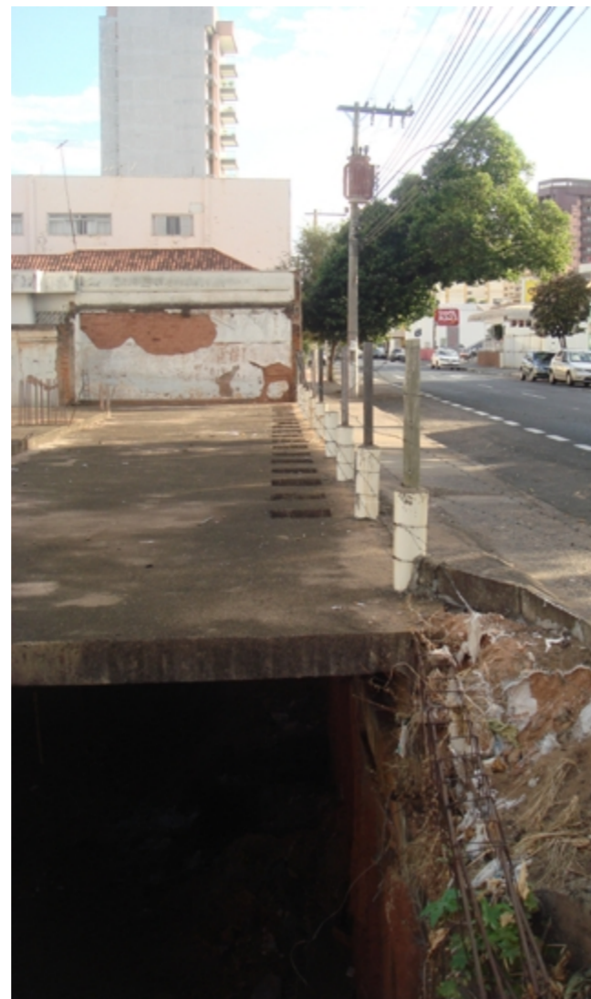
Figura 67. Ruína. Fonte: Guilherme Vendramini, 2013.
