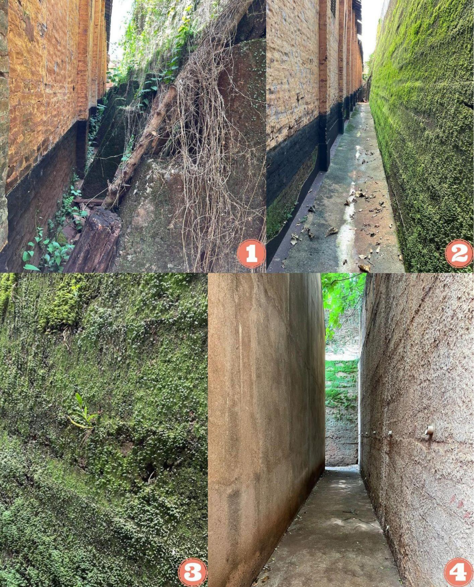
Figura 62: conjunto de imagens dos corredores dos fundos. Em ordem: muro de arrimo (1), muro de arrimo com passagem (2), destaque para muda de orquídea (3), corredor que forma uma cascata quando chove (4). Fonte: autora, 2021.
