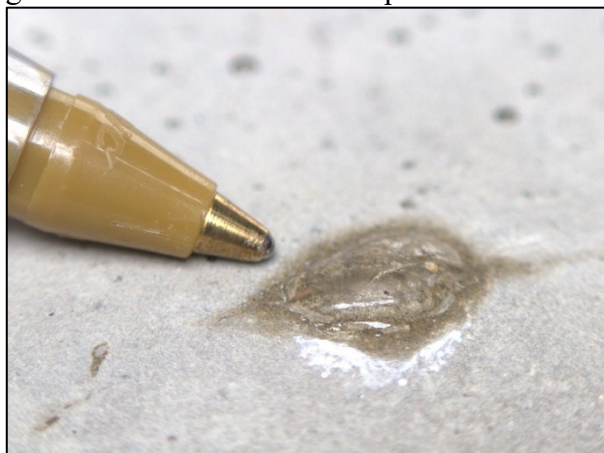
Figura 68 – Gel exsudado na superfície do concreto
