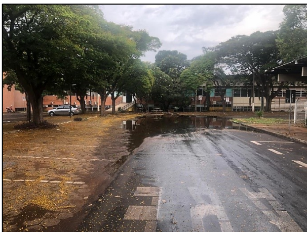
Figura 64 – Trecho n.º 17 – 20. Ocorrência de alagamento pós-precipitação de 14,2 mm em uma hora. Visão a partir do ponto n.º 20
