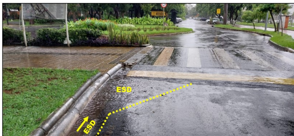
Figura 68 – Faixa elevada para travessia pedestres, próximo ao ponto n.º 1 do Campus Santa Mônica, em carga de escoamento, imediatamente após precipitação.
