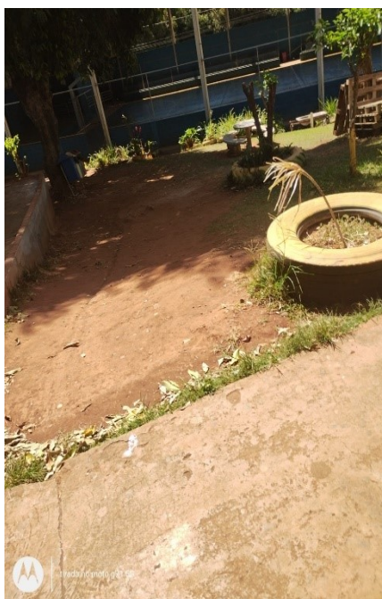
Figura 12 - Rampa improvisada de acesso à quadra esportiva
