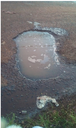
Figura 5 – Buraco com água
