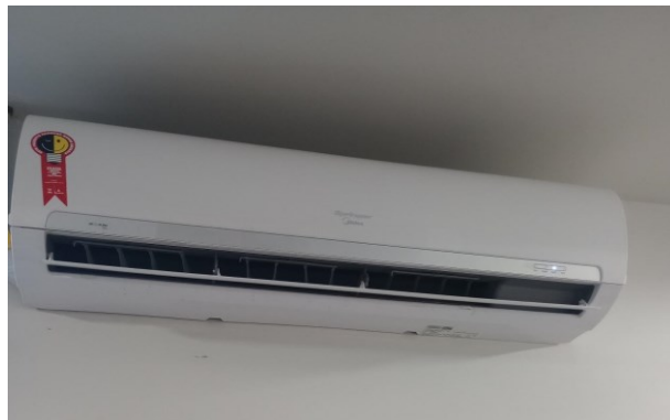
Figura 14 – Ar-condicionado instalado na sala do data center .
