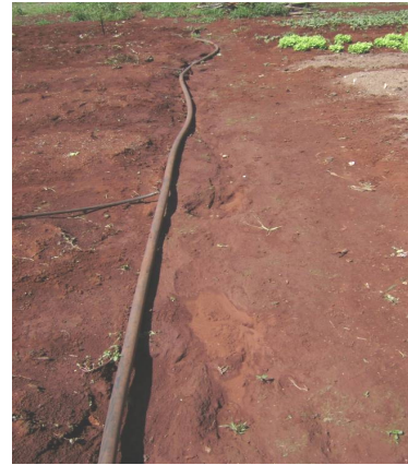
Figura 19 - Identificação de processos erosivos na horta (Foto: Kahlau, J., 2009).
