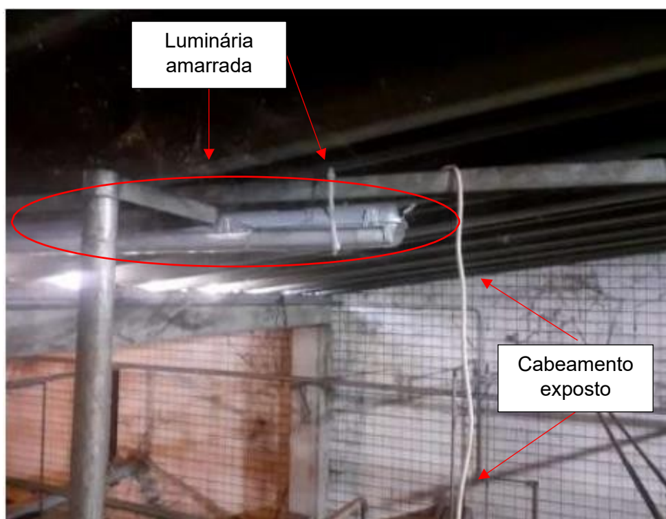
Figura 8: Luminária amarrada de maneira errada e com cabeamento fora da infraestrutura (Acervo de documentos da empresa "A", 2023).
