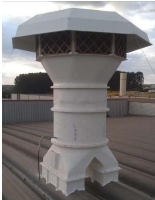
Figura 33: Visão detalhada de injetor no telhado da fábrica (Acervo de documentos da empresa “A”, 2023).
