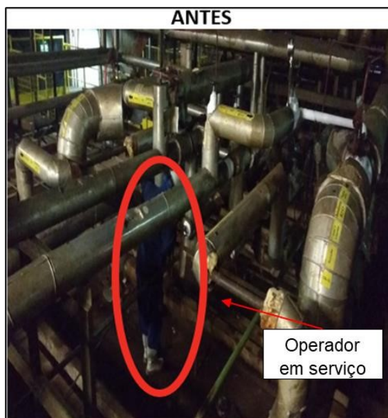
Figura 51: Comandos de válvulas do giro freezer, com operador em serviço (Acervo de documentos da empresa “A”, 2023).
