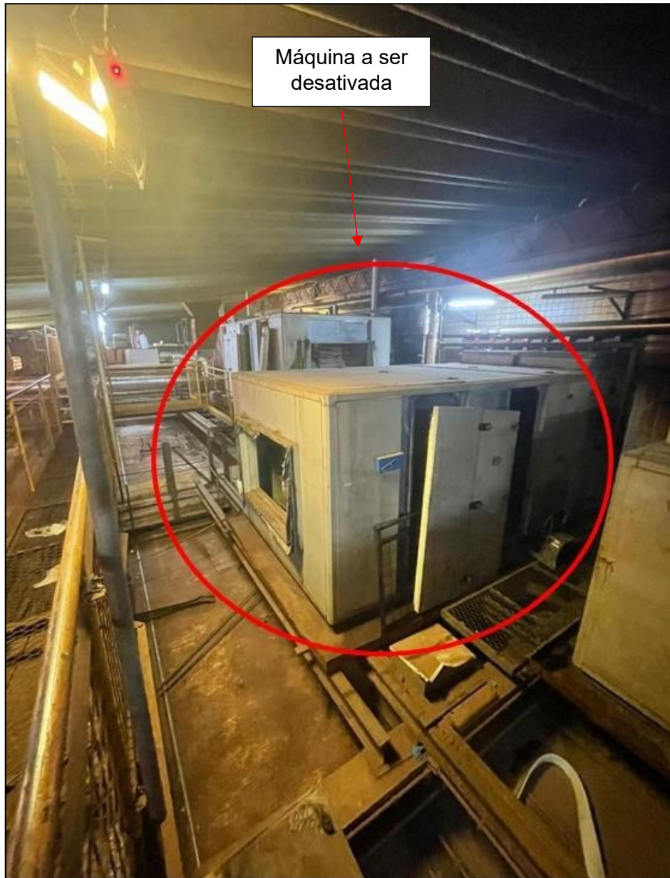
Figura 19: Máquina 2 de climatização desativada a ser removida (antes) (Acervo de documentos da empresa "A", 2023).
