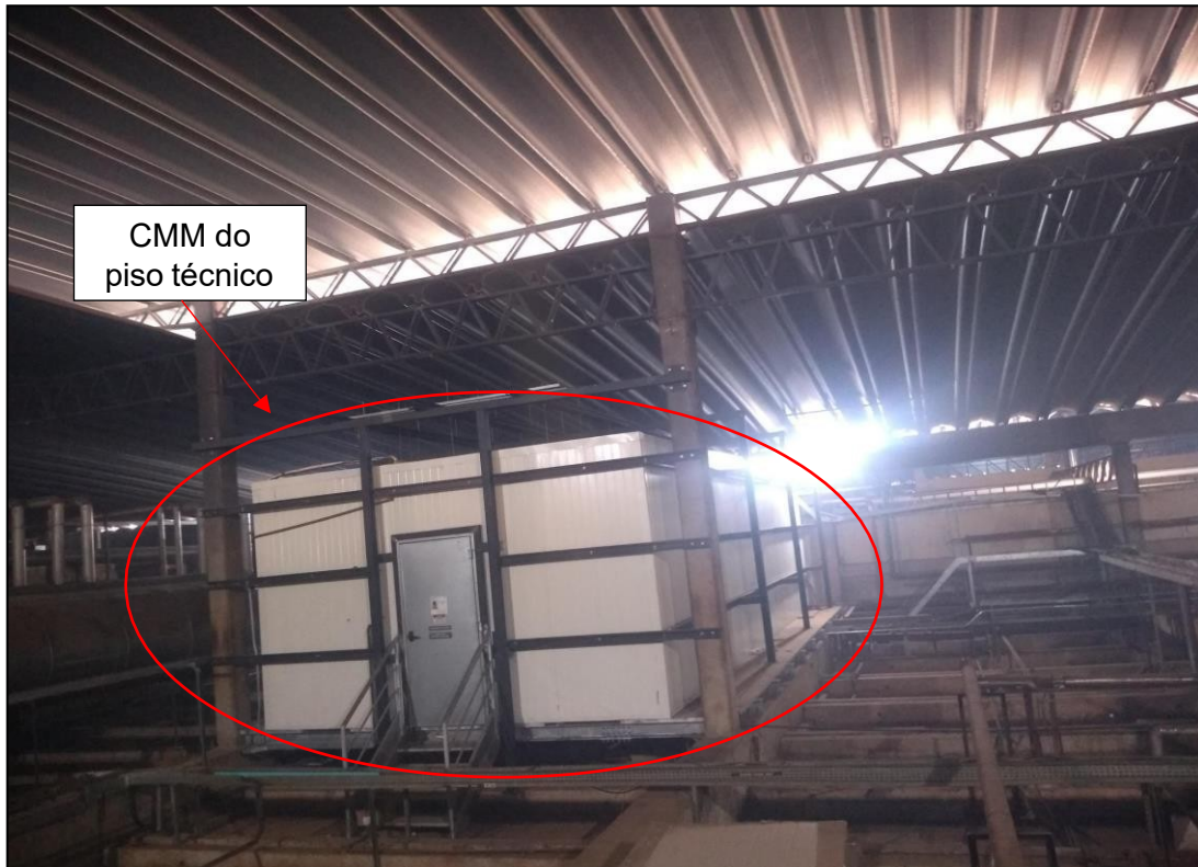
Figura 24: Novo local do CCM do piso técnico (Foto retirada pela equipe de manutenção da empresa “A” a pedido do autor, 2023).
