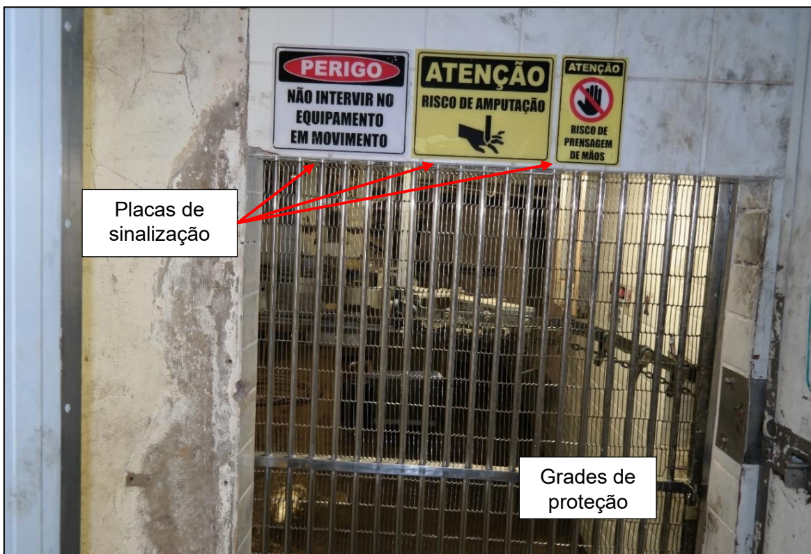
Figura 29: Grades de proteção e sinalização de segurança da nórea entrando no piso técnico. (Foto retirada pela equipe de manutenção da empresa “A” a pedido do autor, 2023).
