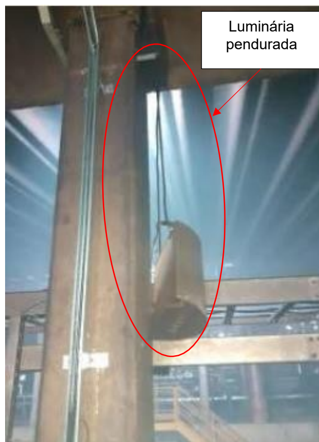
Figura 7: Luminária fora de funcionamento e com luminária pendurada e com cabos expostos (Acervo de documentos da empresa "A", 2023).
