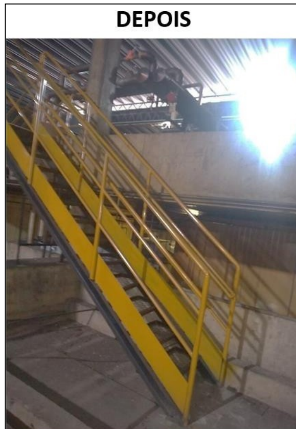
Figura 44: Acesso a comandos de válvulas das estufas atual (Foto retirada pela equipe de manutenção da empresa “A” a pedido do autor, 2023).
