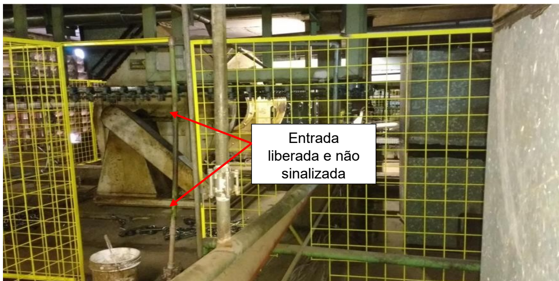
Figura 25: Entrada do transportador aéreo sem sinalização e sem porta com fechadura (Acervo de documentos da empresa “A”, 2023).
