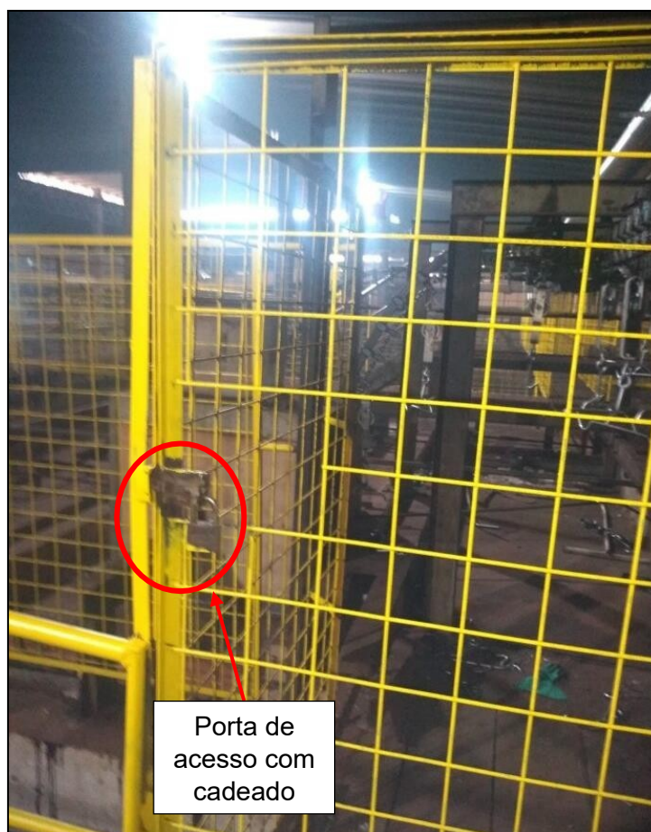
Figura 28: Porta de acesso da nórea no piso técnico trancada (Foto retirada pela equipe de manutenção da empresa “A” a pedido do autor, 2023).
