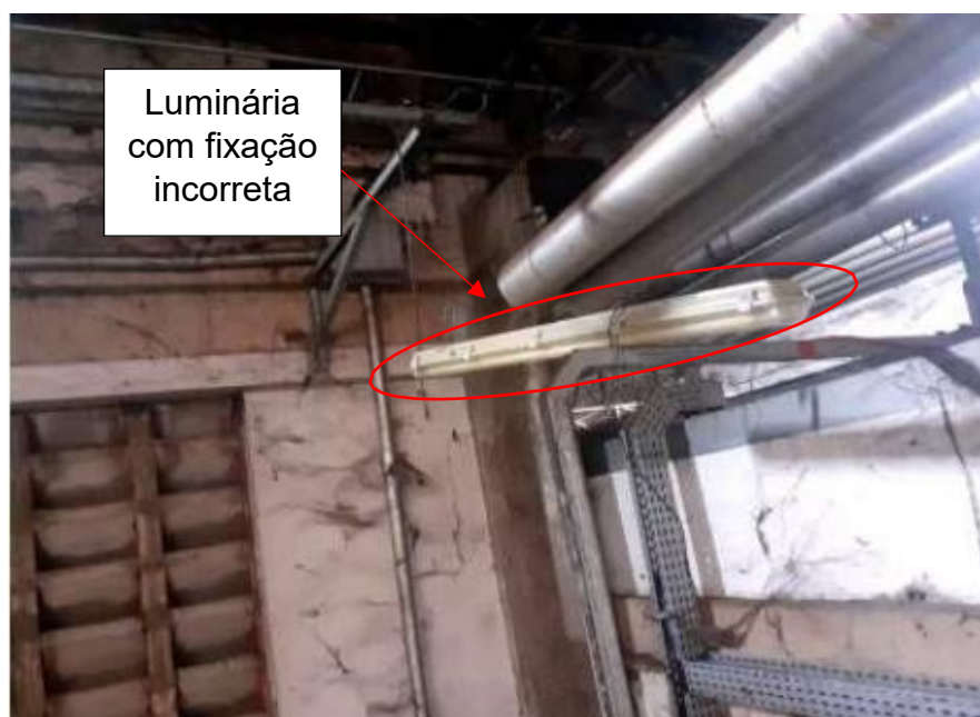
Figura 6: Luminária fora do padrão correto de instalação com fixação incorreta (Acervo de documentos da empresa “A”, 2023).
