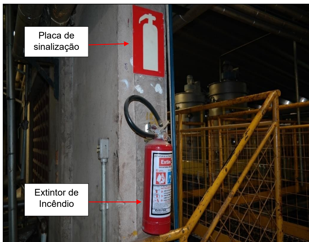
Figura 38: Foto de extintor e sinalização localizados no piso técnico (Foto retirada pela equipe de manutenção da empresa "A" a pedido do autor, 2023).
