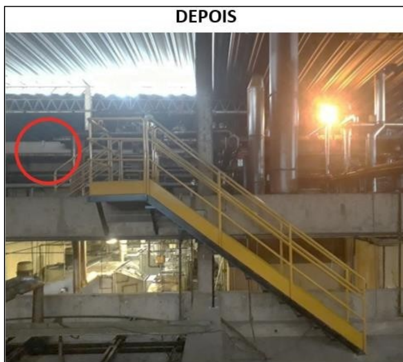
Figura 43: Acesso a comandos de válvulas das estufas atual (Foto retirada pela equipe de manutenção da empresa “A” a pedido do autor, 2023).
