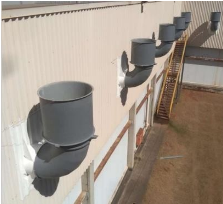
Figura 32: Visão detalhada de exaustores na lateral da fábrica (Acervo de documentos da empresa “A”, 2023).
