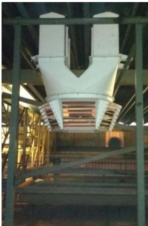
Figura 34: Parte interna do sistema de ventilação (Acervo de documentos da empresa “A”, 2023).
