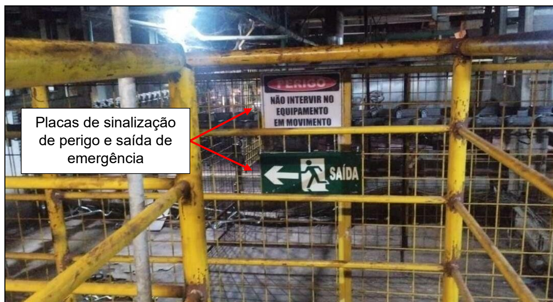
Figura 26: Grades de proteção e placa de sinalização da nórea e saída de emergência (Foto retirada pela equipe de manutenção da empresa “A” a pedido do autor, 2023).
