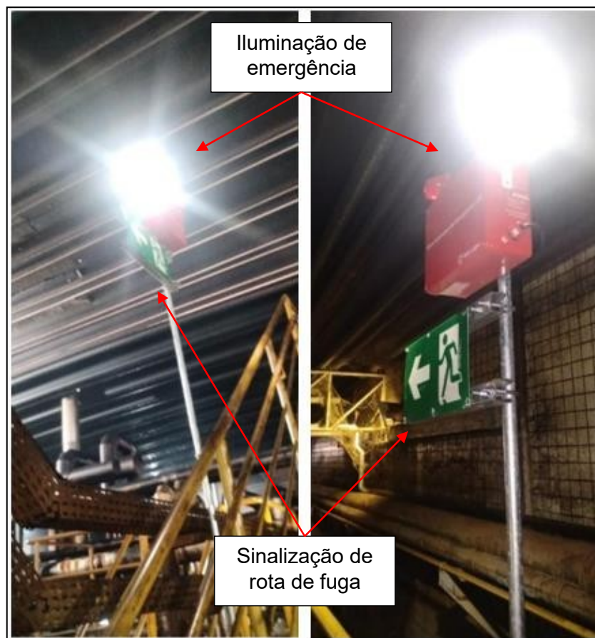
Figura 40: Foto de iluminação e sinalização de emergência do piso técnico (Acervo de documentos da empresa "A", 2023).
