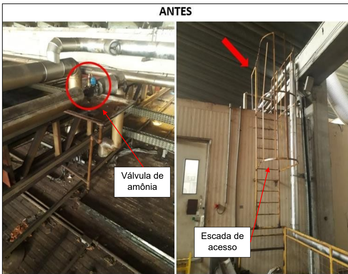
Figura 45: Situação anterior para o acesso a cavaletes de válvulas de amônia (Acervo de documentos da empresa “A”, 2023).
