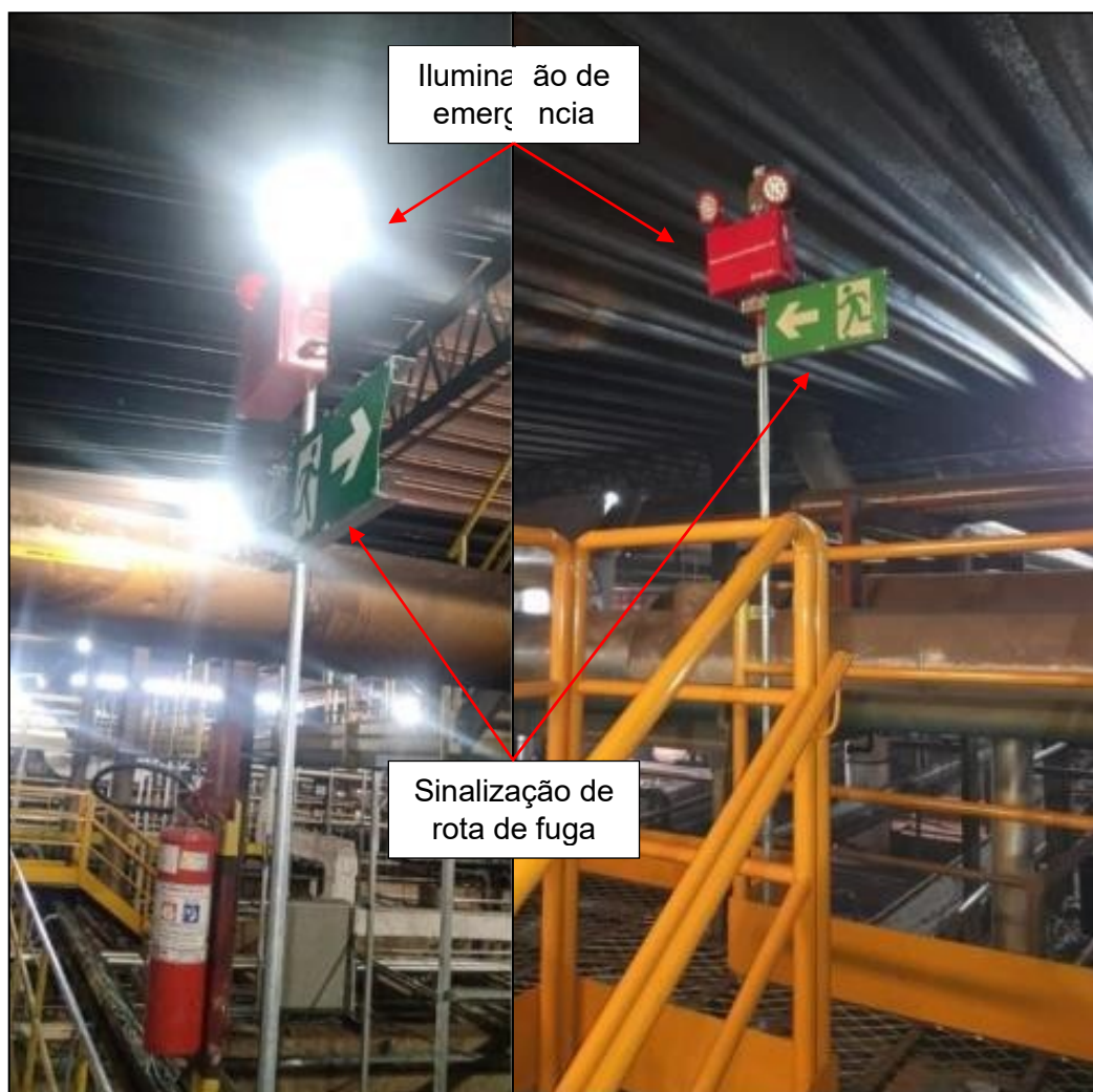
Figura 41: Foto de iluminação e sinalização de emergência do piso técnico (Acervo de documentos da empresa “A”, 2023).
