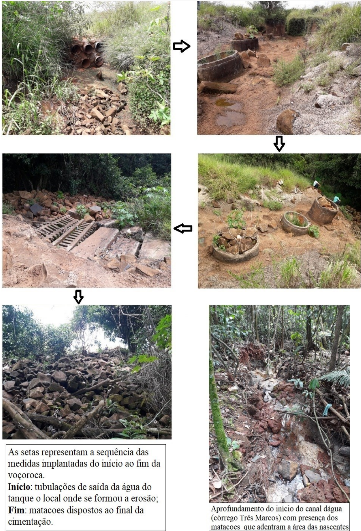
Figura 43 – Voçoroca aterrada e depois cimentada – margem direita do ambiente de nascentes do córrego Três Marcos – BHCbVT.
