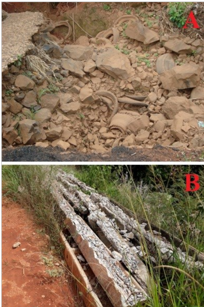
Figura 45 – A: Restos da cimentação da voçoroca rompida deixando amostra os resíduos da construção civil, pneus e matacões; B: Resíduos da construção civil (Postes de energia elétrica) – margem direita do ambiente de nascentes do córrego Três Marcos – BHCVT.
