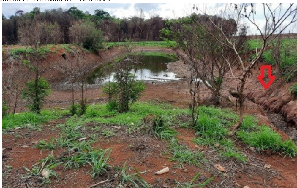
Foto 48 – Bacia de retenção/detenção – seta indica o rompimento dele com formação de erosão em sulcos – Margem direita C. Três Marcos – BHCbVT.
