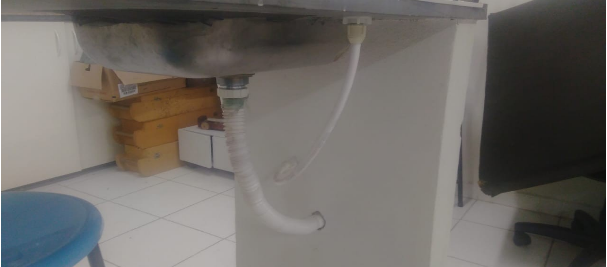
Figura 9: Registro fotográfico evidenciando o sifão constituído de material não resistente à ação química.
