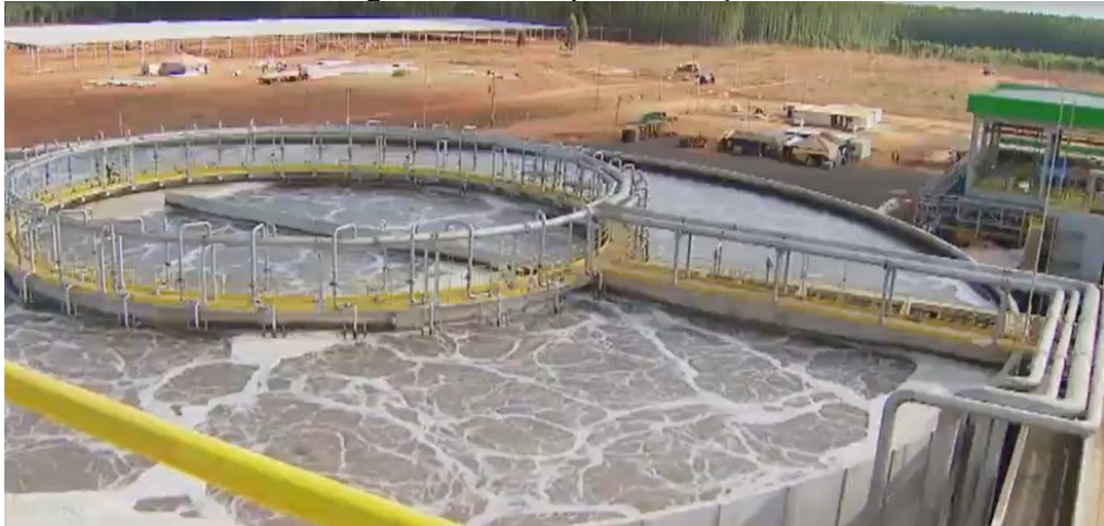
Figura 29 – Tanque de aeração.
