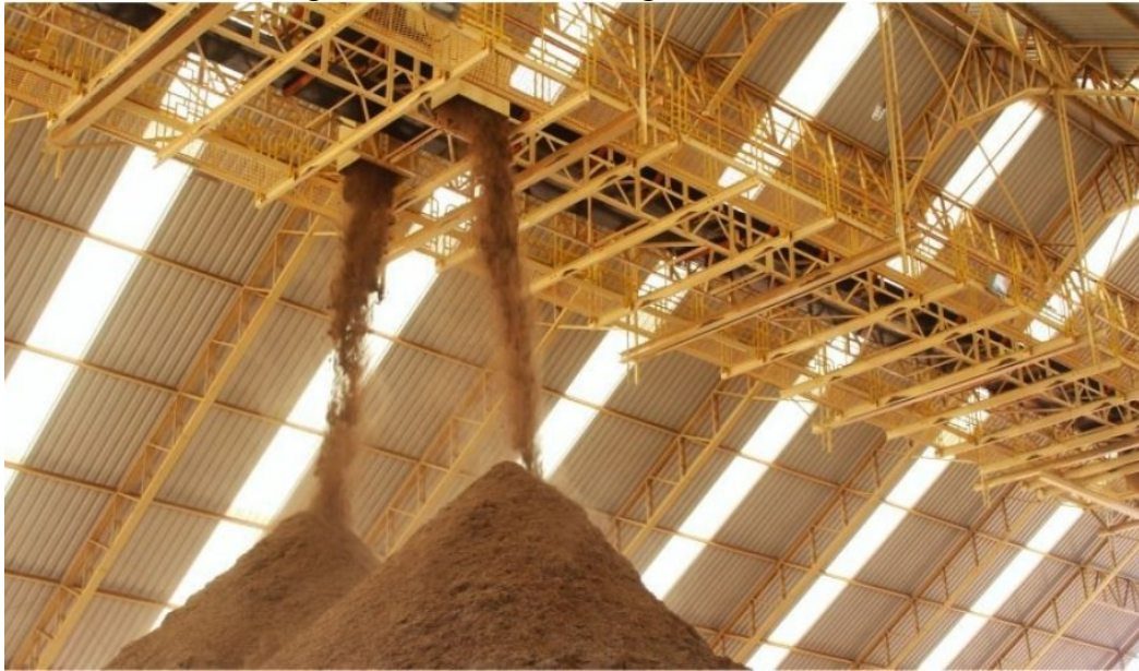
Figura 11 – Silo de estocagem de cavacos.
