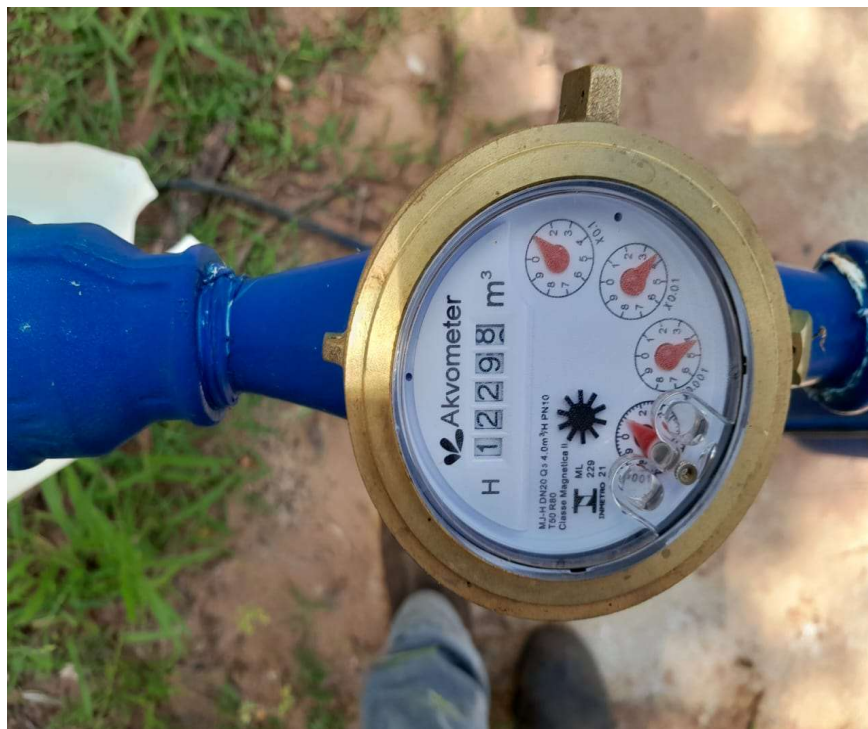
Figura 7 – Hidrômetro da instalação.
