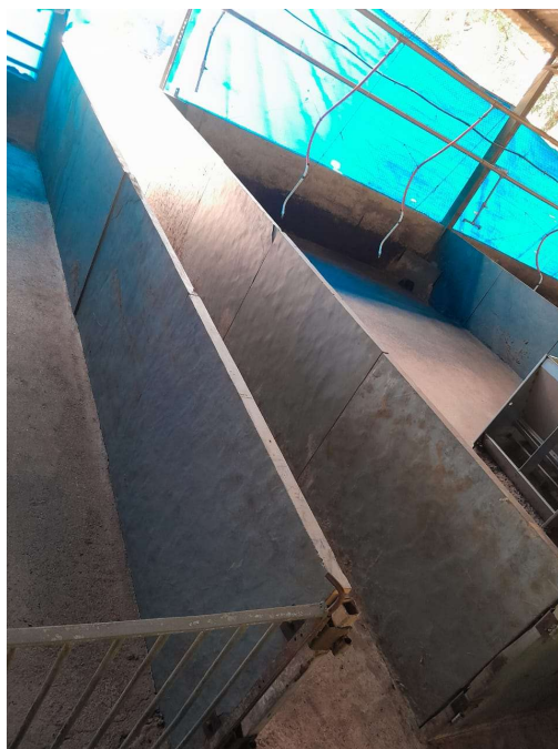
Figura 10 – Foto interna do corredor de acesso ao embarcador.
