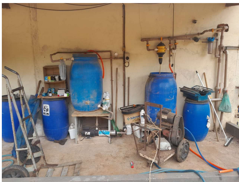
Figura 16 – Sistema de misturadores.
