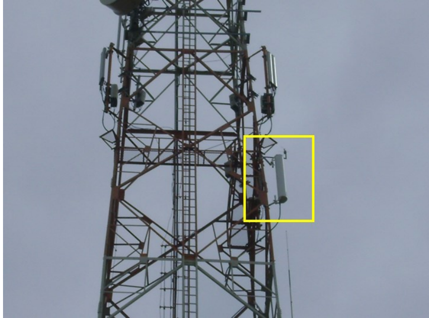
Figura 11: Indicação da antena slot instalada em lateral de torre
