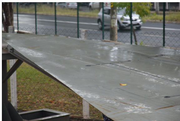
(a) Vista dos PZT instalados na seção circular do teto do tanque.
