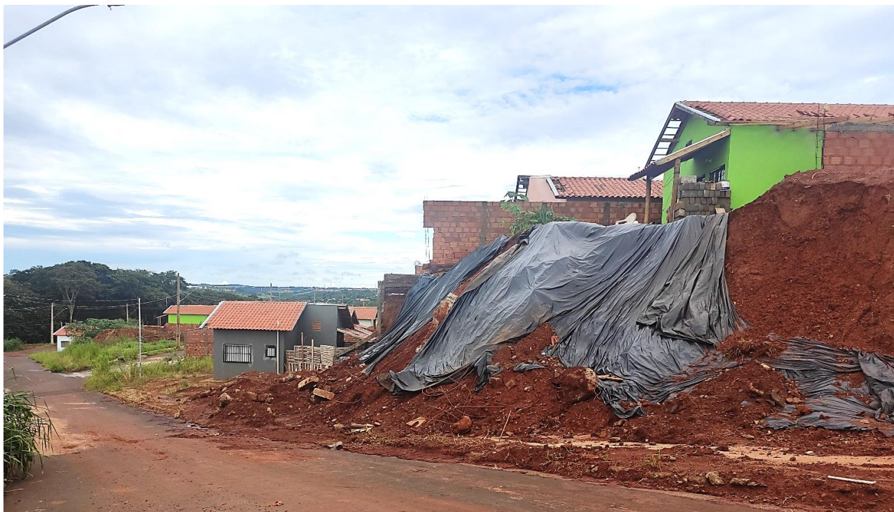
Figura 13: Alfredo Freire IV – Danos causados por chuvas (2023)
