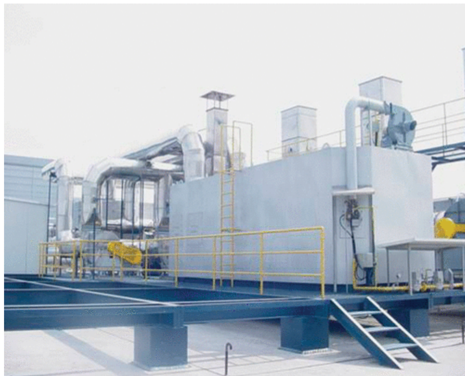
Figura 5- Região de oxidação
