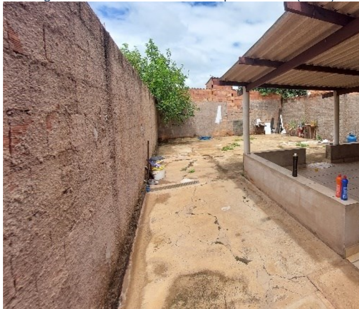
Figura 84 - Ausência de área permeável (RSB)
