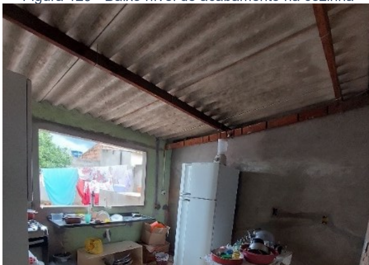
Figura 129 - Baixo nível de acabamento na cozinha
