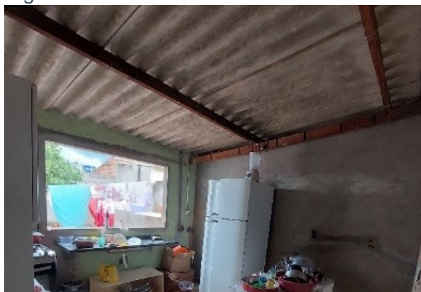
Figura 36 - Falta de acabamento nos cômodos
