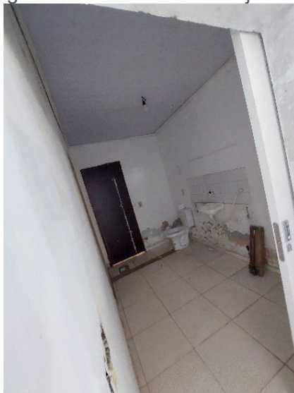
Figura 119 - Cômodos sem janelas
