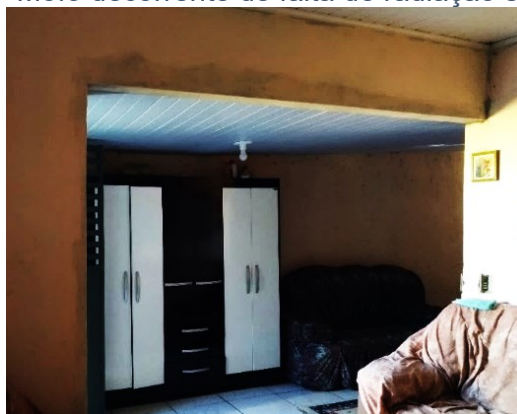
Figura 77 - Mofo decorrente de falta de radiação solar (RSB).
