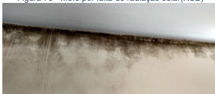
Figura 79 - Mofo por falta de radiação solar(RSB)
