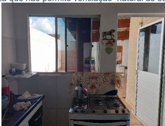
Figura 82 - Janela que não permite ventilação natural ao ser fechada (R2A4)
