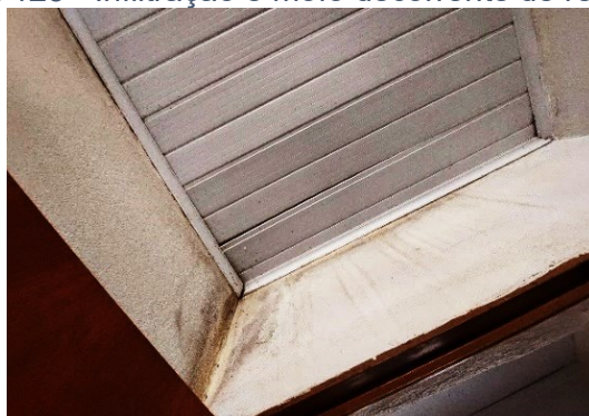
Figura 125 - Infiltração e mofo decorrente de reformas
