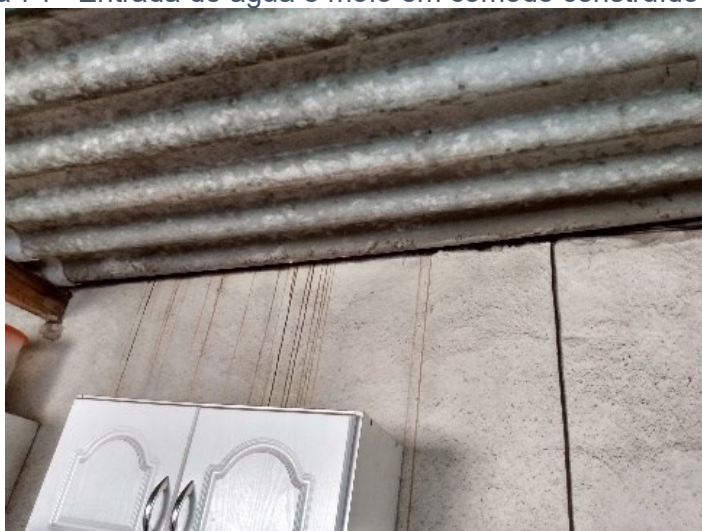
Figura 74 - Entrada de água e mofo em cômodo construído (RSB)
