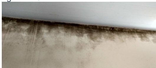
Figura 126 - Mofo decorrente de reformas
