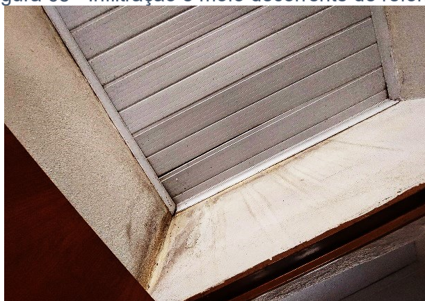
Figura 68 - Infiltração e mofo decorrente de reforma
