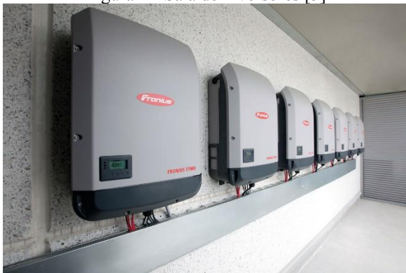
Figura 2 - Sala de inversores [5]
