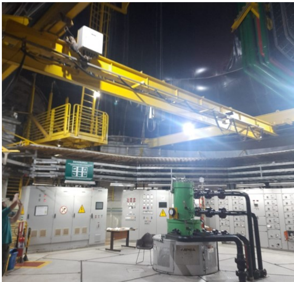
Figura 12: Casa de Máquinas
