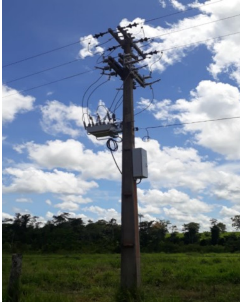
Figura 4: Religador automático de rede de distribuição
