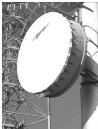
Figura 68 - Antena parabólica alimentada pelo ponto focal com blindagem e radome.
