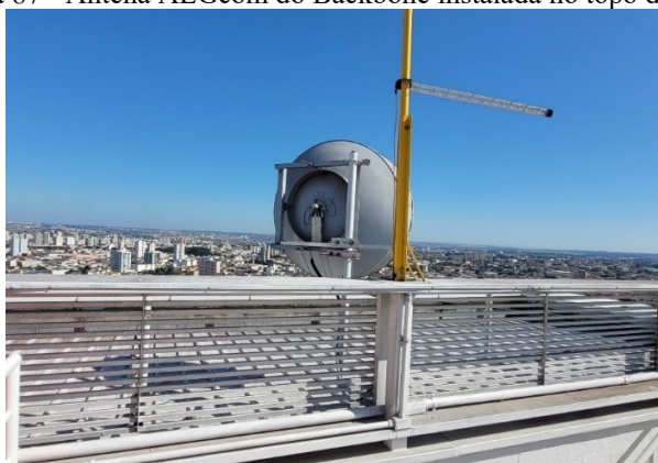
Figura 87 - Antena ALGcom do Backbone instalada no topo do UBT.
