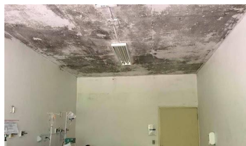
Imagem 2: Mofo estabelecido em teto de sala hospitalar
