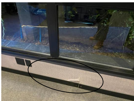
Figura 17: Descolamento de papel de parede pela presença de umidade
