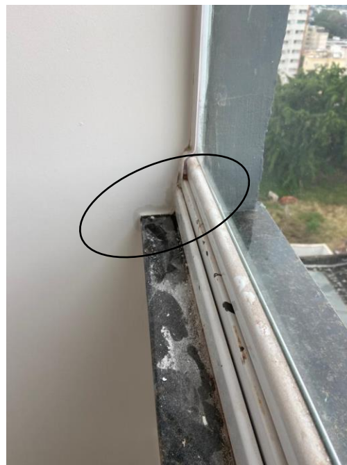
Figura 18: Presença de umidade na parede decorrente da vedação insuficiente da esquadria
