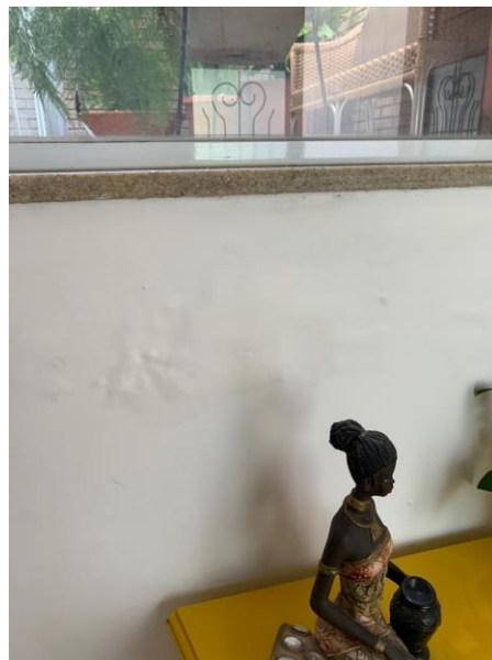
Figura 16: Empolamentos causados pela presença de água nas juntas do piso acima
