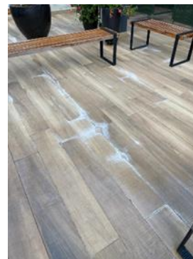
Imagem 1: Presença de eflorescências em porcelanatos na área externa
