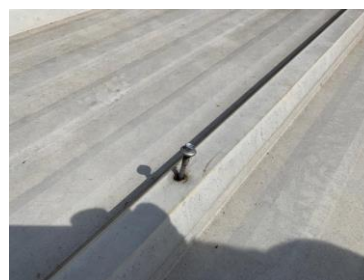
Imagem 4: Fixação incorreta do parafuso
