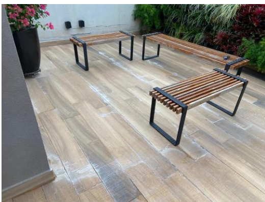
Figura 6: Presença de manchas brancas de eflorescência no piso.
