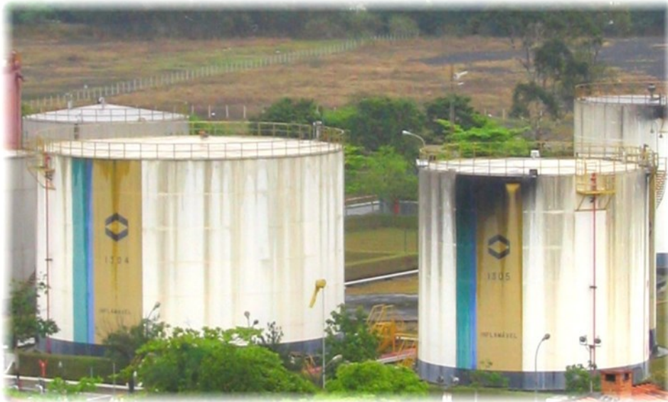
Figura 8: Tanques de armazenamento
