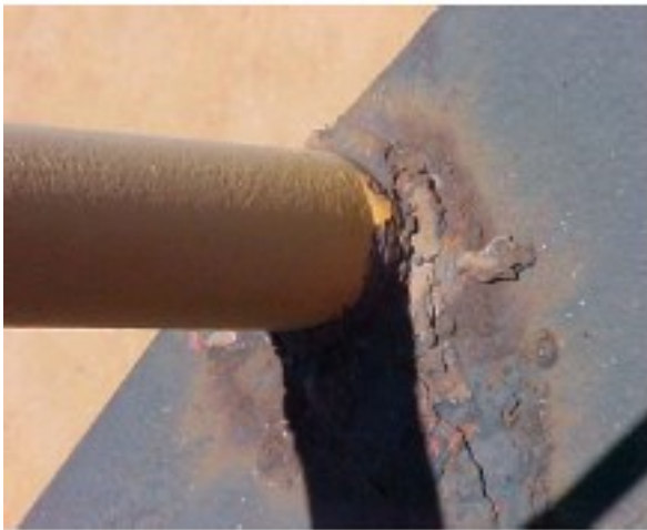
Figura 18: Afigura mostra corrosões externas
