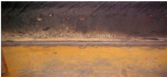
Figura 17: Mostra o costado do tanque internamente, atestando a corrosão
