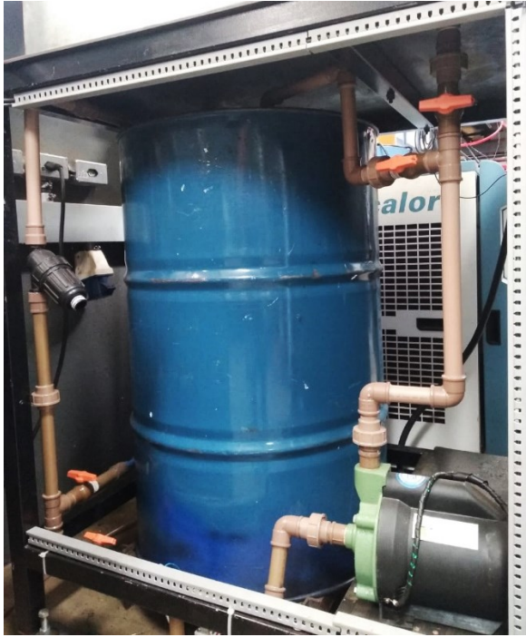
Figura 0.14 – Sistema de recirculação de água por bomba
