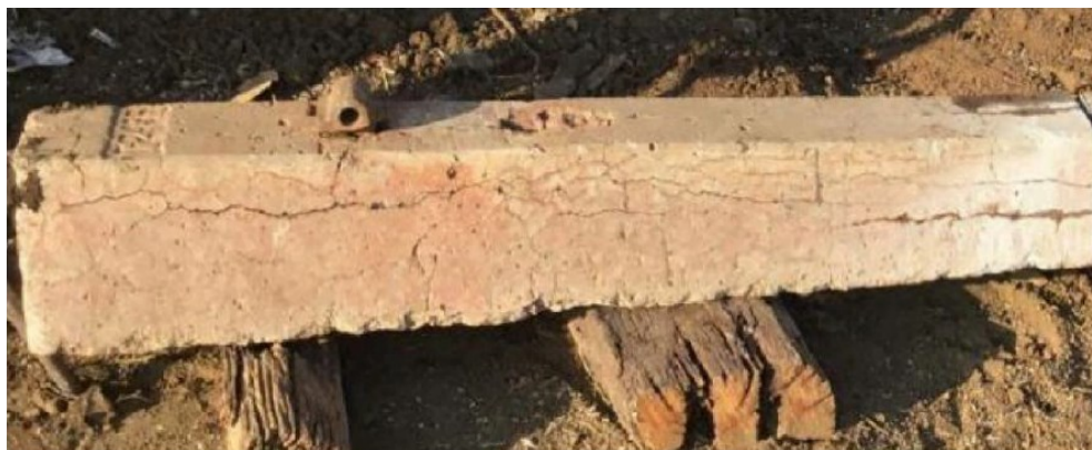
Figura 17. Rachadura do dormente de concreto protendido por DEF
