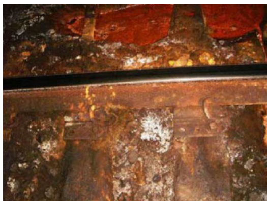
Figura 7. Corrosão em dormente de aço
