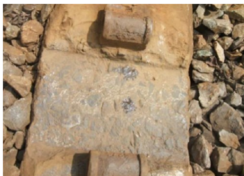
Figura 12. Falha do dormente de concreto devido à abrasão no local do trilho
