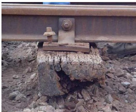
Figura 3. Deterioração do dormente de madeira devido à decomposição fúngica
