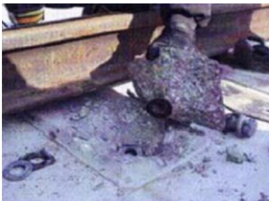
Figura 18. Trinca cônica devido ao ciclo de gelo e degelo
