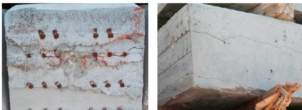
Figura 11. Dormentes fissurados após fabricação
