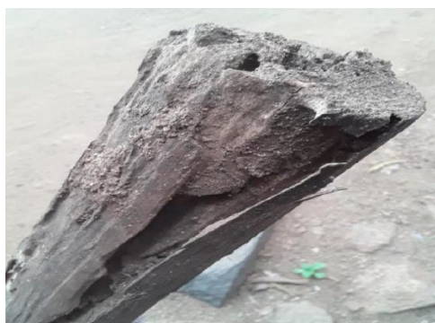
Figura 5. Rachadura lateral do dormente de madeira
