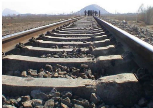
Figura 14. Dormentes danificados por descarrilamento
