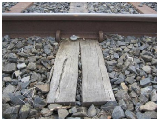
Figura 4. Rachadura lateral do dormente de madeira
