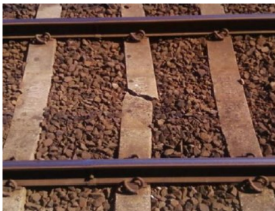
Figura 15. Dormentes danificados por carregamento de alto impacto
