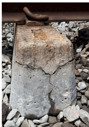
Figura 16. Fissuras em dormentes de concreto devido a RAA
