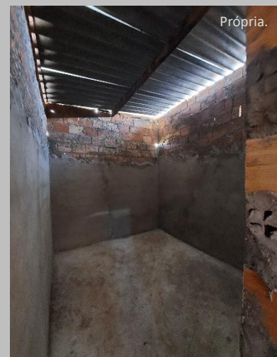
QUARTO CRIADO SEM PREVISÃO DE JANELA
