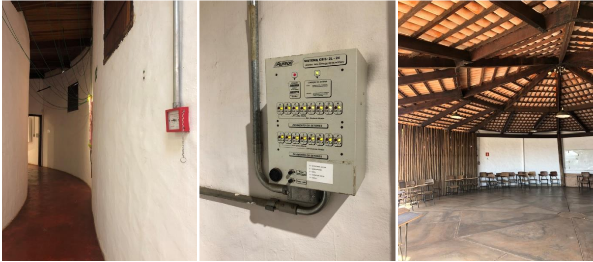
Figuras 59, 60 e 61: Levantamento fotográfico dos pontos de acionamento e central de alarme no museu de arte sacra e salão comunitário Fonte: O Autor (2022).
