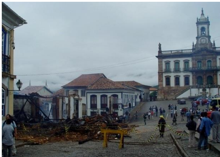
Figura 3: Escombros do antigo Hotel Pilão, na Praça Tiradentes, Ouro Preto/MG Fonte: Acervo Eduardo Tropa (2003).
