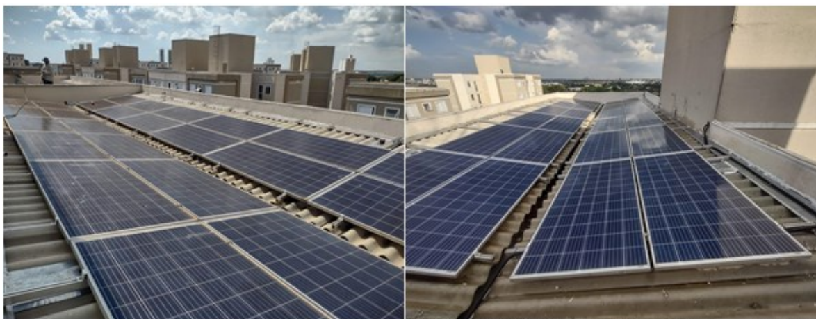
Figura 22 - Foto das placas fotovoltaicas do Residencial Unipark Central Park, no bairro Laranjeiras
